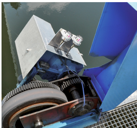
Lagerschmierung mittels Schläuchen an einem Nachklärbeckenräumer.
