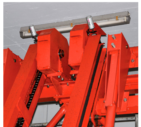
Kettenschmierung am Grobrechen mit simalube, ausgerüstet mit Bürsten.
