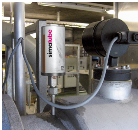
Lagerschmierung: Über ein kurzes Rohr wird der Schmierstoff zum Lager geführt.
