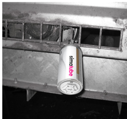
simalube schmiert das Wälzlager eines Förderbandes.
