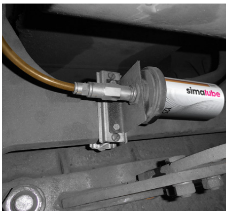
Der 125 ml Spender ist am Chassis einer Niederflurtram installiert. Der Schmierstoff wird über einen Schlauch zum Schmierpunkt geführt.
