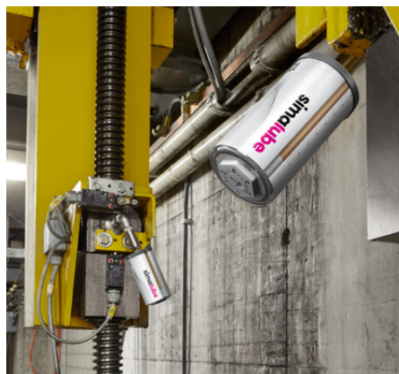
Spindeln einer Hubanlage für Eisenbahnwaggons und Lokomotiven werden mit einem simalube 125 ml über 12 Monate geschmiert.
